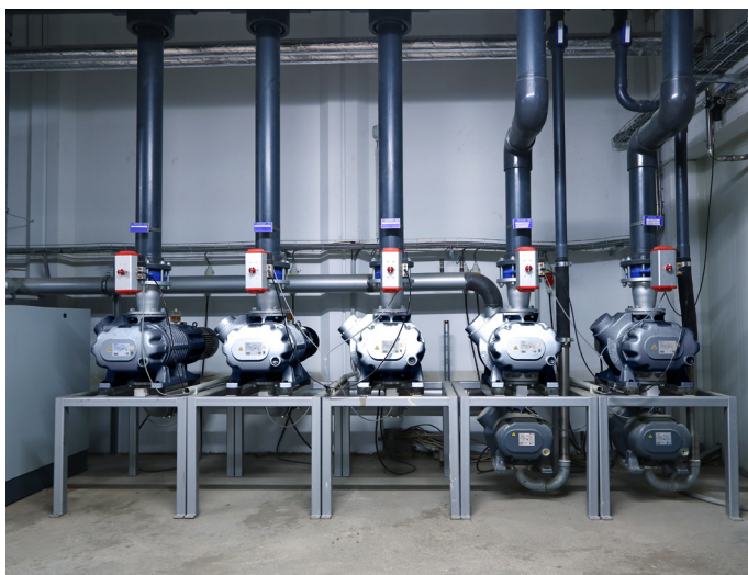
DRB booster pumps
